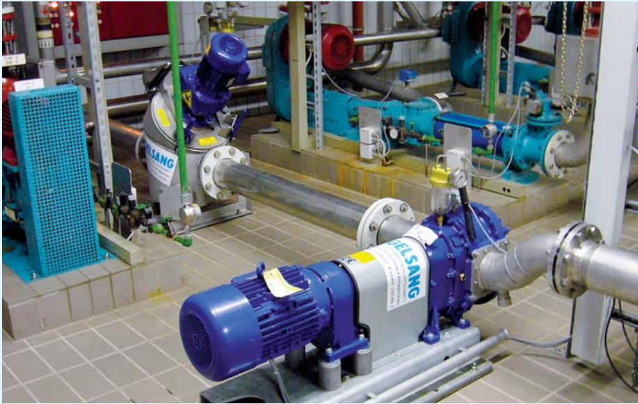
MAZERATOR UND PUMPE: vor der Hochspannungs-Desintegrationsanlage zur Beschickung des Faulturmes mit Überschuss-Schlamm
