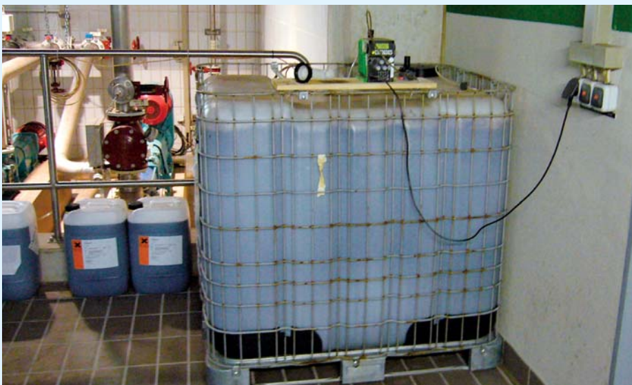
FÜR DIE TENSIDLÖSUNG: Vorratsbehälter und Dosierpumpe
